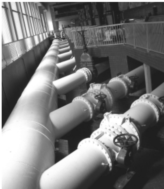
Hall de refoulement. Installations des captages de Rochefort (Régie des Eaux de Grenoble).
